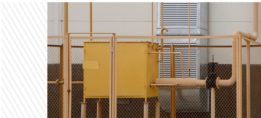
ЗМОНТОВАНИЙ ГАЗО-РОЗПОДІЛЬНИЙ ПУНКТ (ГРП) ВІДПОВІДНО ДО ПРОЄКТНИХ РІШЕНЬ
