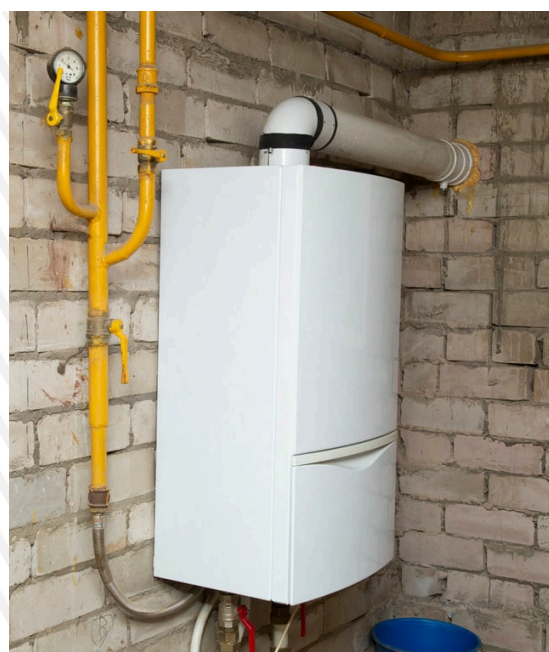
ГАЗОВІ/ ЕЛЕКТРИЧНІ КОТЛИ ВІДПОВІДНО ДО ПРОЄКТНИХ РІШЕНЬ
